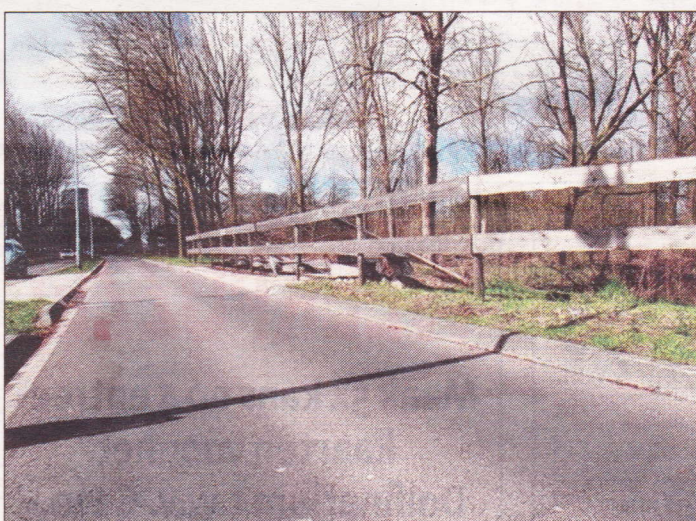
■ De brugleuning over de Dommel aan de Orpheuslaan staat er al jaren zo bij.
